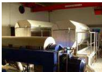
Centrifugation des boues
